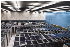
Salle de serveurs (2009)
